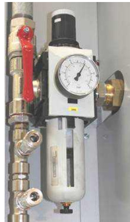
Fig. 83: Alimentazione dell'aria compressa
