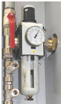
Abastecimiento de aire comprimido
